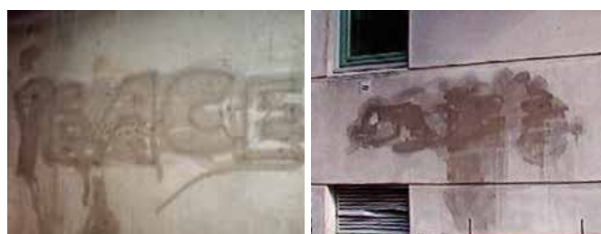
TVÅ EXEMPEL PÅ LMISSYCKADE KLOTTERSANERINGAR – VÄGGARNA BÄR TYDLIGA SPÅR AV KLOTTERET OCH RENGÖRINGSMEDELET HAR FÖRSTÖRT FASADERNA.
